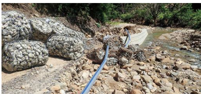
被災した導水管
