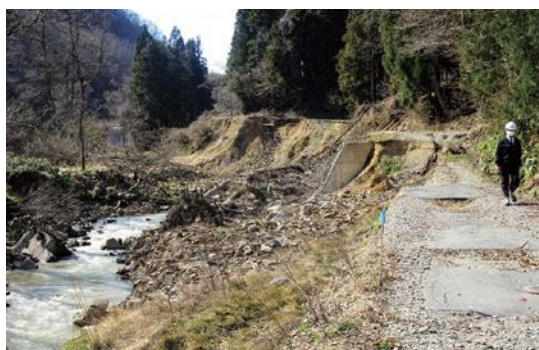
復旧が急がれる被災箇所
