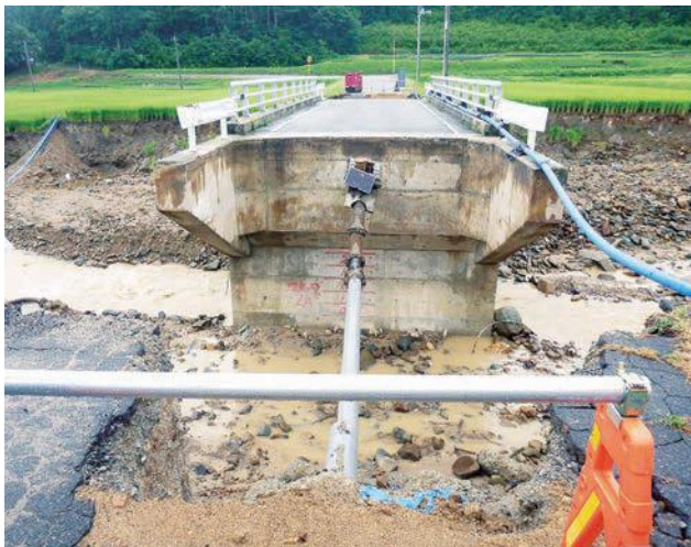
被災した水道管
