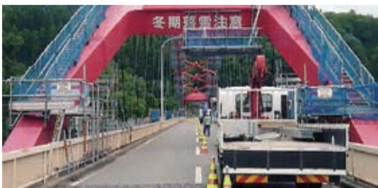
修復が待たれる中津川橋
