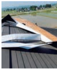
強風で剥がされたトタン
